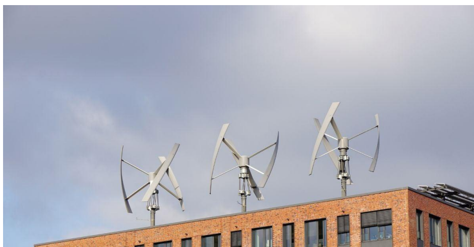
11. ábra Függőleges tengelyű szélturbina lapostetőn létesítve (Forrás: https://www.attainablehome.com/do-rooftop-small-wind-turbines-make-sense/ )
